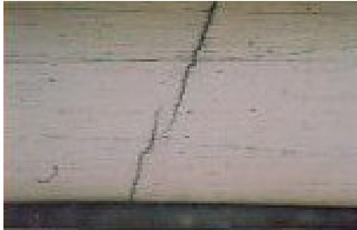
Gambar 4.4. Foto retak mikro pada matrik
