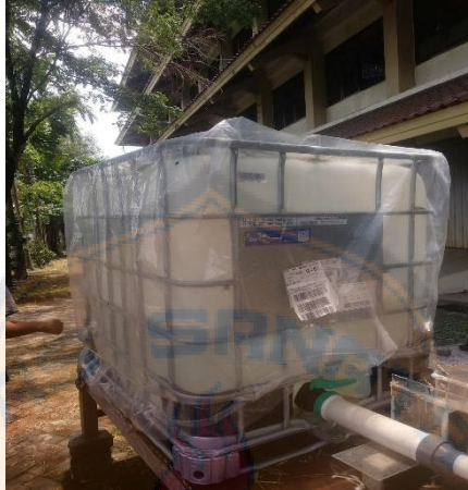
Gambar 3.2 Bak tampungan input
