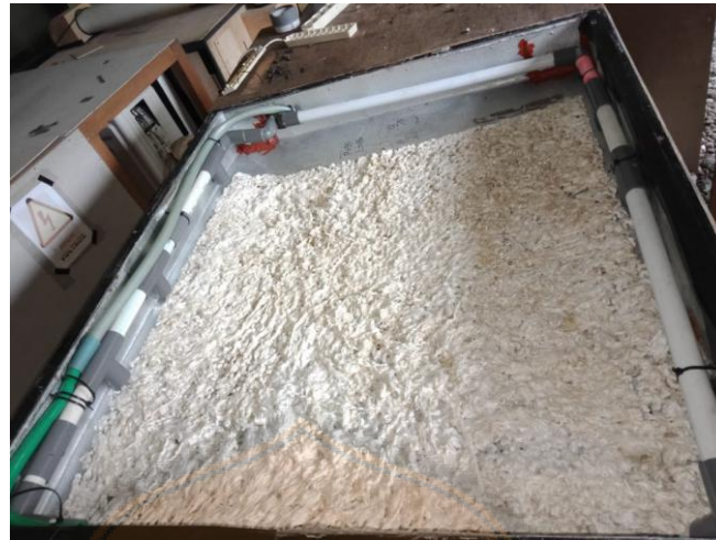
Gambar 3.7 Cooling Pad Tampak Atas
