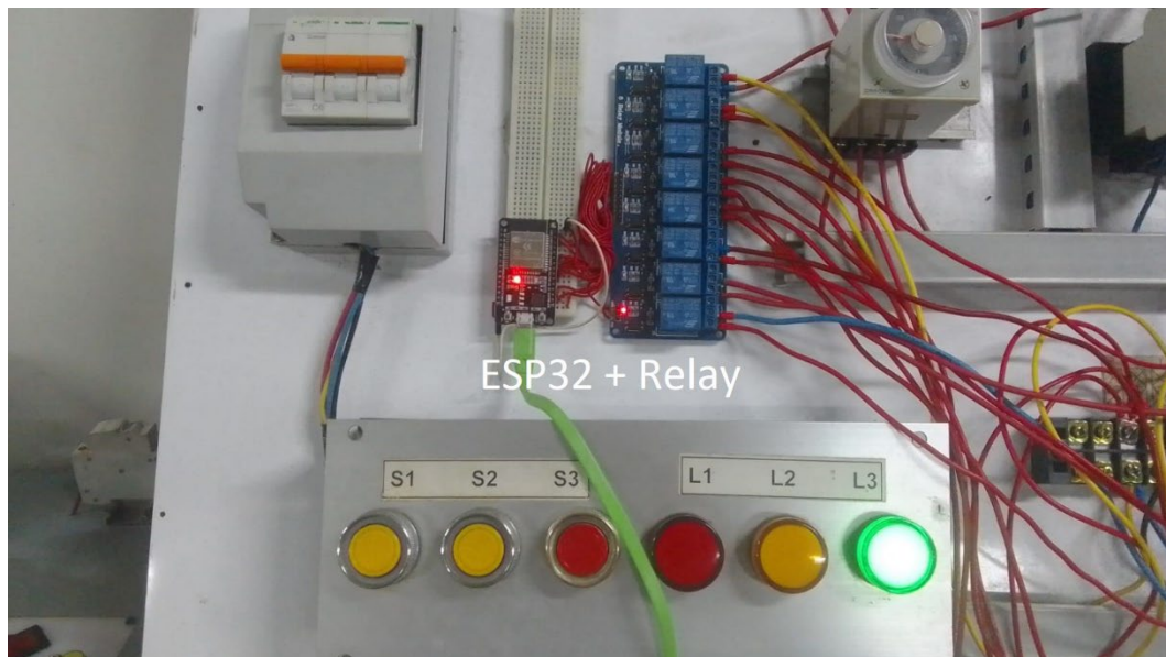
Gambar 4. Pemasangan perangkat ESP32 + Relay, yang digunakan untuk mengontrol rangkaian pengawatan dari jarak jauh
