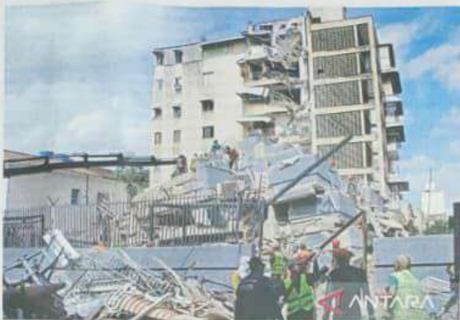
Tim melakukan pekerjaan pembersihan puing di sebuah bangunan yang runtuh setelah gempa bumi di Caracas Venezuela, pada 25 Juni 2026.
